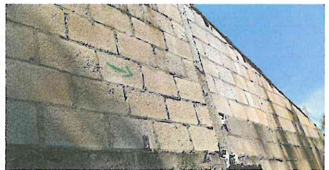
Foto 6: Repello de pared de atrás de la cocina
